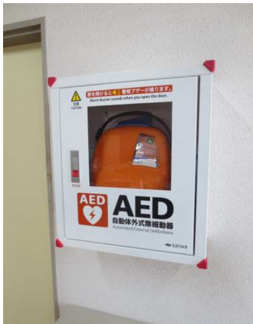
AED（自動体外式除細動器）が設置されました
